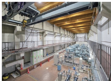
水密化されたポンプ棟
