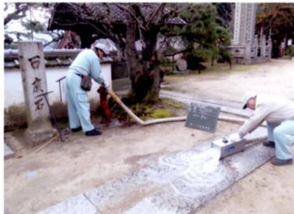
防災設備保守点検状況(西國寺)
