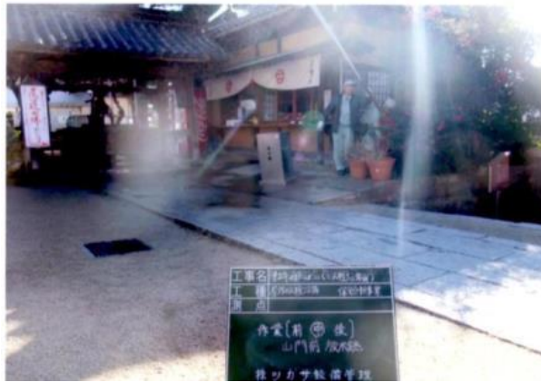
防災設備保守点検状況(浄土寺)
